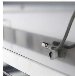
Innenfühler zur kontinuierlichen Temperaturüberwachung
