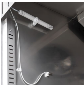
Controllo dell'umidità con sonda elettronica
